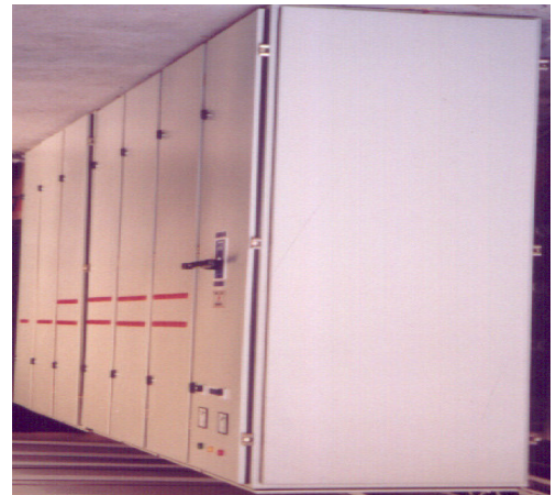
(Main L.T Panel)
